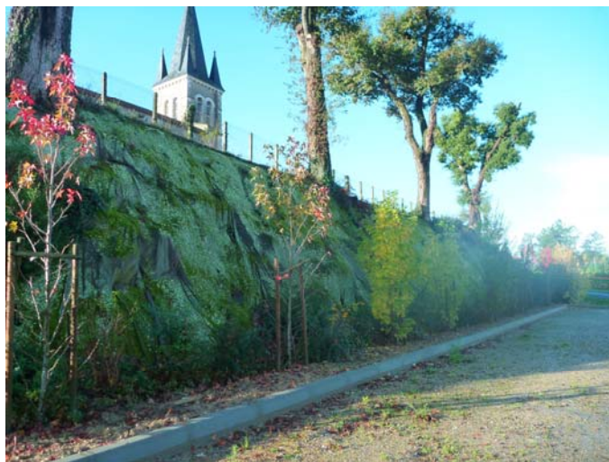
Vue au pied du talus: le paillage biodégradable, tel un rideau plissé, n'est pas suffisant pour permettre à la végétation de s'y accrocher
