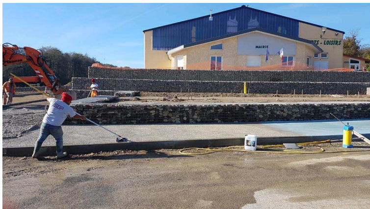
Travaux en cours autour de la mairie et du hall des sports : 700.000 € de parvis, parkings et soutènement
